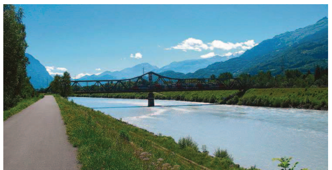
Die alte Rheinbrücke wird nun saniert und nicht wie ursprünglich geplant neu gebaut. Bild: pd
